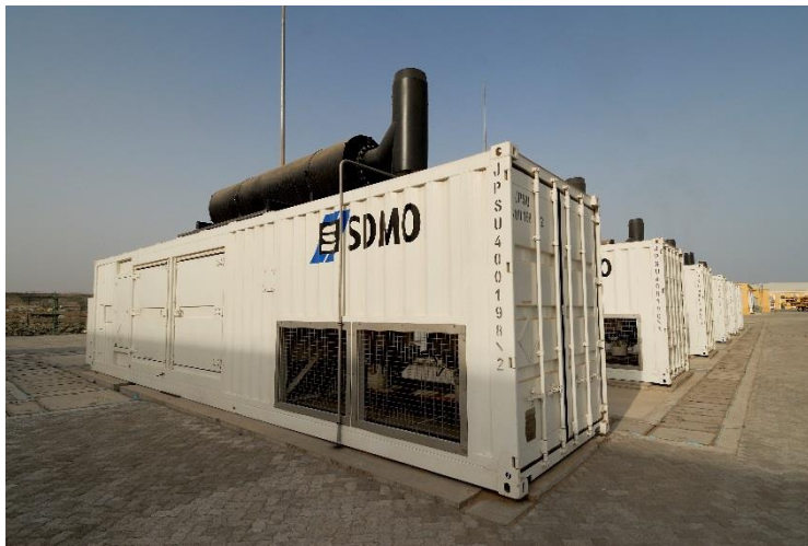
Ilustr. 4: Grupos electrógenos en contenedores CPU40
