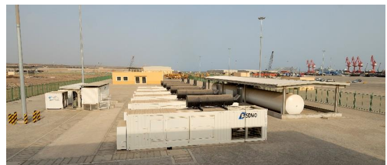
Ilustr. 3: La central finalizada en la instalación de Doralé. Al fondo pueden distinguirse las grúas del puerto.
