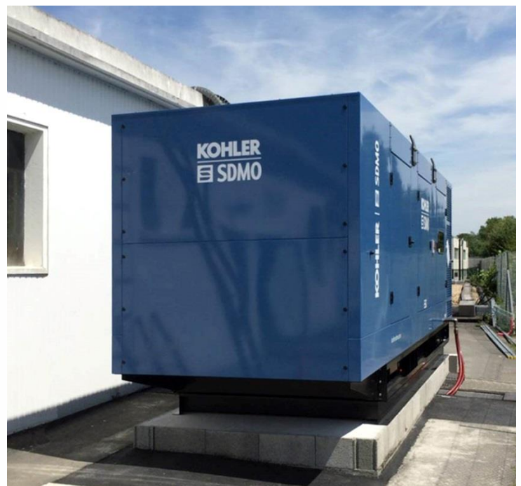
Ilustr. 2: El grupo electrógeno KD900 en versión carenada de la planta de tratamiento de aguas de Ancenis.
