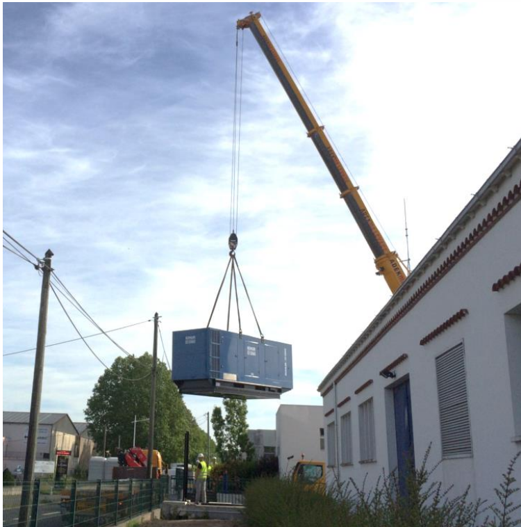
Ilustr. 3: El grupo KD900 en curso de mantenimiento en la planta
