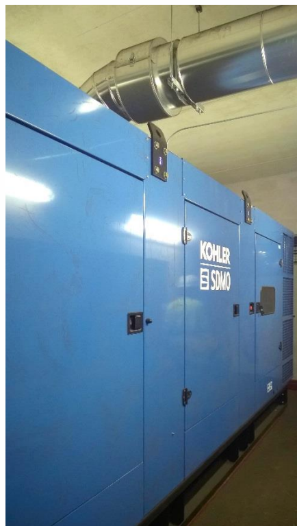
Illus. 2 : Le tout nouveau groupe électrogène KD1100 en version capot installé dans le local
