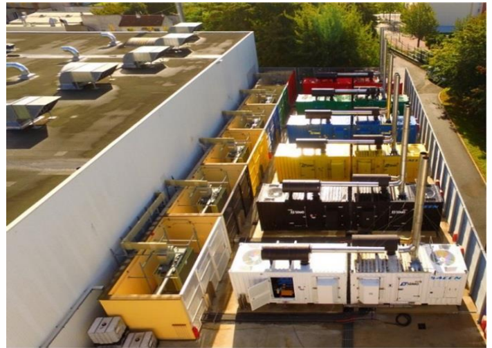
Illus. 2. Les six nouveaux groupes électrogènes ont été raccordés à la première installation et ont chacun un code couleur défini.
