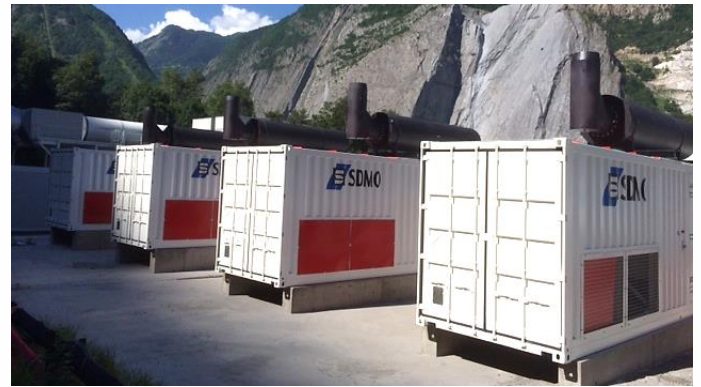
Illus. 2. Les quatre groupes électrogènes 1900 kVA installés au pied de la falaise du Pas du Roc
