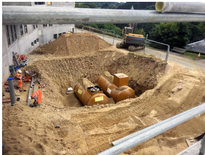
Hay dos depósitos enterrados en el lugar: uno para los grupos electrógenos y otro para la caldera de fuelóleo
