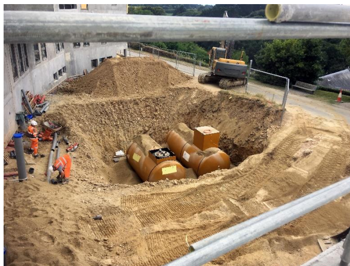
Deux cuves sont enterrées sur le site : une pour les groupes électrogènes et une pour la chaufferie fioul
